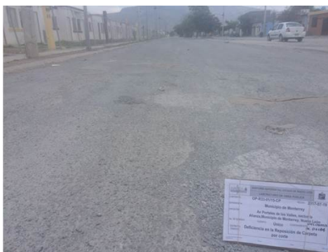
Deficiencia en la reposición de la carpeta por corte, en el cadenamiento del 0.003 al 0+184 de la avenida Portales de los Valles.
